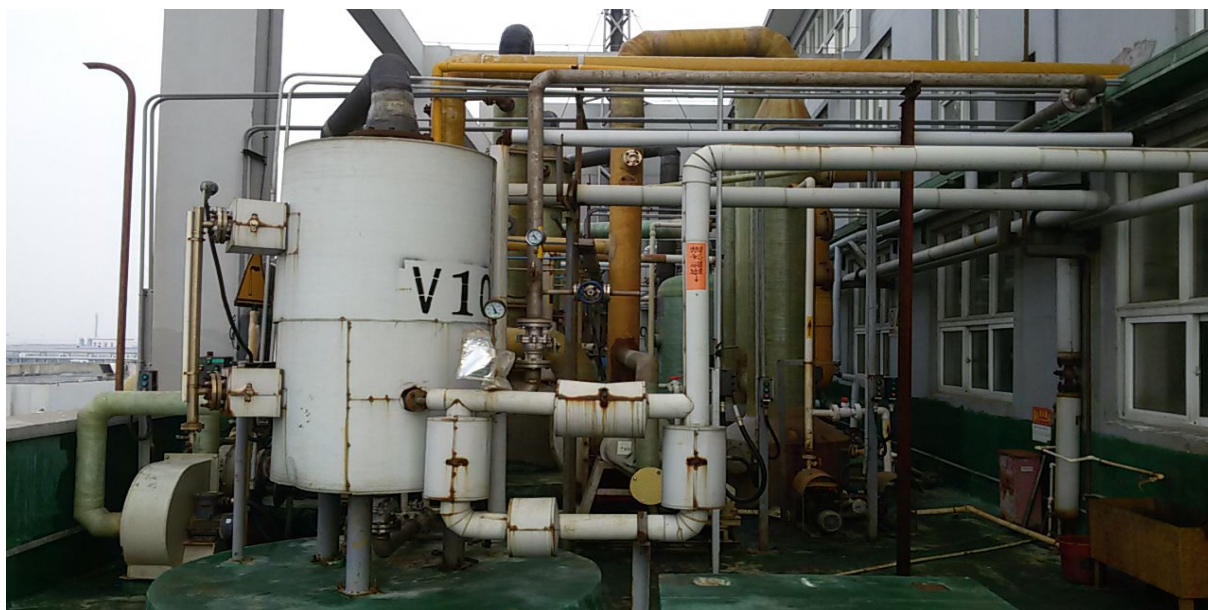
图 4.4 103 车间废气处理设施图
