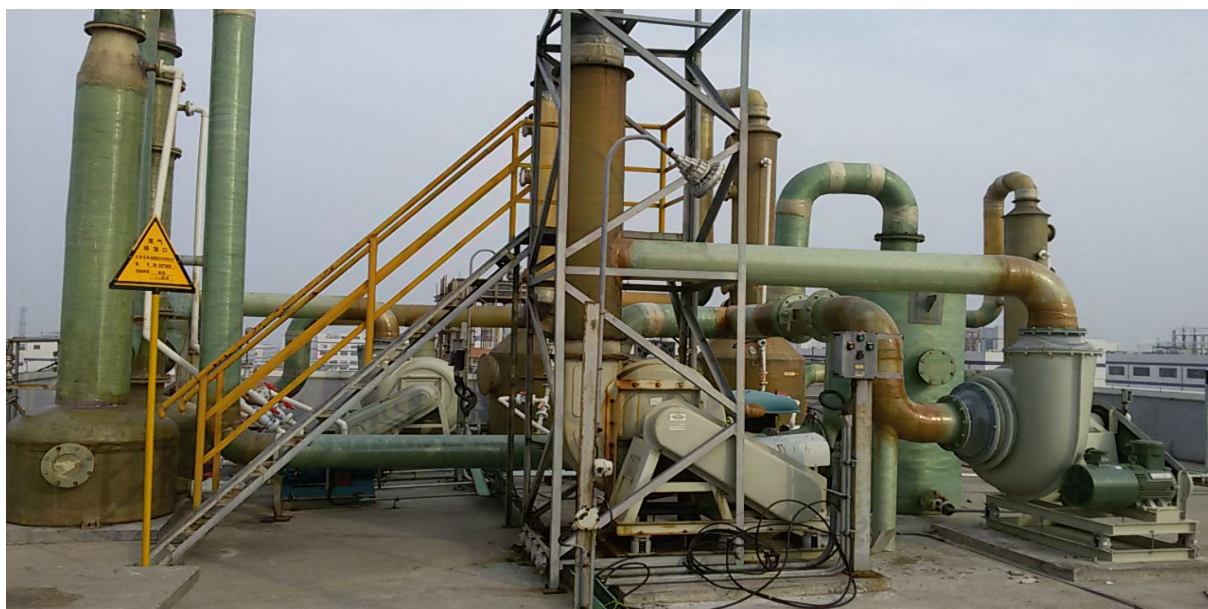
图 4.5 205 车间废气处理设施图
